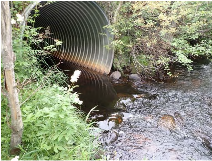
Kuva 3. Ylä-Kerpuajoen yli menevän sillan tierummut. Suotavaa olisi vaihtaa rummut siltaan. Putken suualueutta on selvästi kivetty veden virtauksen hidastamiseksi.
